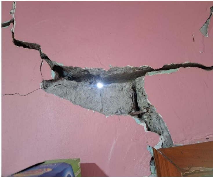
Figura 12. Grietas que comprometen la integridad de la estructura de concreto reforzado.
