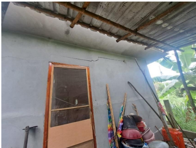
Figura 13. Agrietamiento en loza. Fuente: El autor
