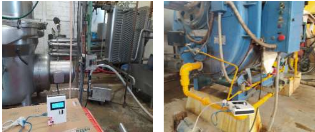
Figura 4. 17 Monitoreo de parámetros en la planta láctea
