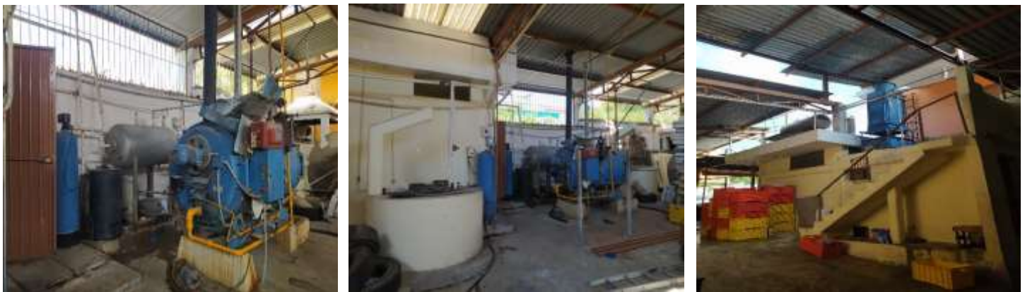
Figura 10 Área de instalación de caldera y tanque de gas
