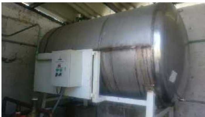
Figura 1. Tanque hidroneumático con Control PLC In Situ.
