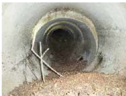
Figura 3. Alcantarilla donde habita el D. rotundus
